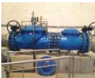
CAJA DE FILTROS PROTEGIENDO UNA VÁLVULA HYDROBLOC
