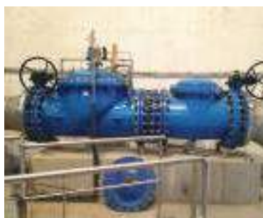
CAJA DE FILTROS PROTEGIENDO UNA VÁLVULA HYDROBLOC
